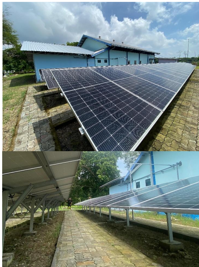
Gambar 2. 1 Instalasi Modul Panel Photovoltaic pada PLTS
