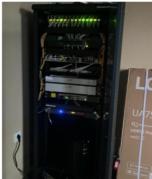
Gambar 1. Kondisi Rak Server di CV Gundara Solusi Bersama (Sumber: Data Peneliti, 2026)
